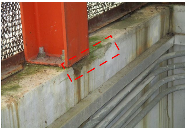
내부 벽체, 콘크리트 파손 (A=0.1m×0.3m)
