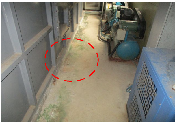
내부 바닥 체수흔적 (A=1.0m×2.0m)
