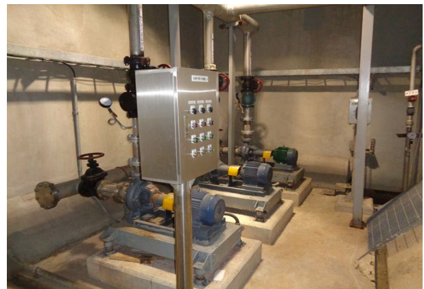
내부 지하2층 여과기펌프 전경
