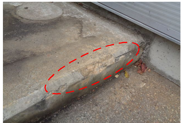
외부 바닥 콘크리트 박리 (A=0.1m×0.5m)
