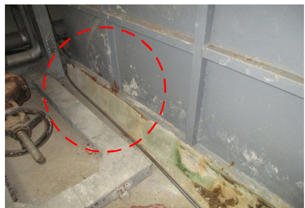
내부 바닥 도장 들뜸 (A=1.0m×0.2m)
