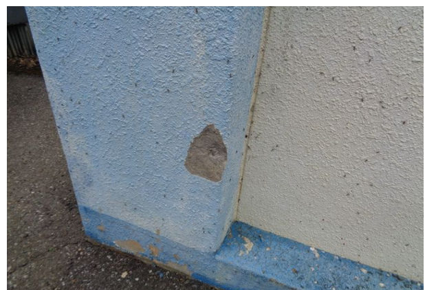
외부 벽체 마감재 파손 (A=0.1m×0.1m)
