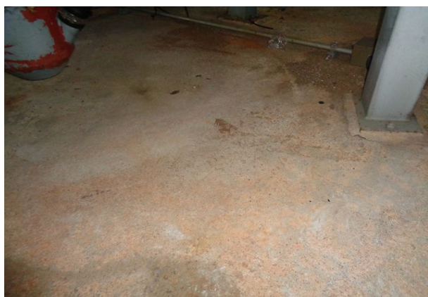
사여과지 내부 바닥 표면열화 (A=8.0m×6.0m)
