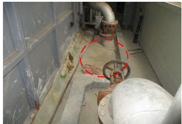
내부 바닥 체수흔적 (A=0.5m×2.0m)
