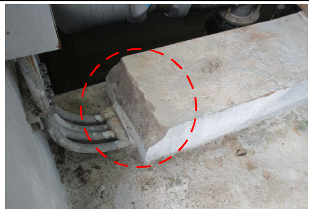
내부 설비 받침, 콘크리트 박락 (A=0.1m×0.3m)
